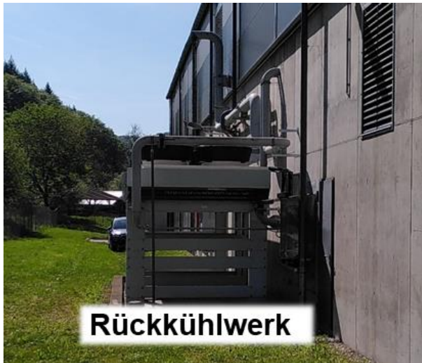
Abb. 29: Rückkühlwerk Biomasse-HKW Kläranlage Ebingen
