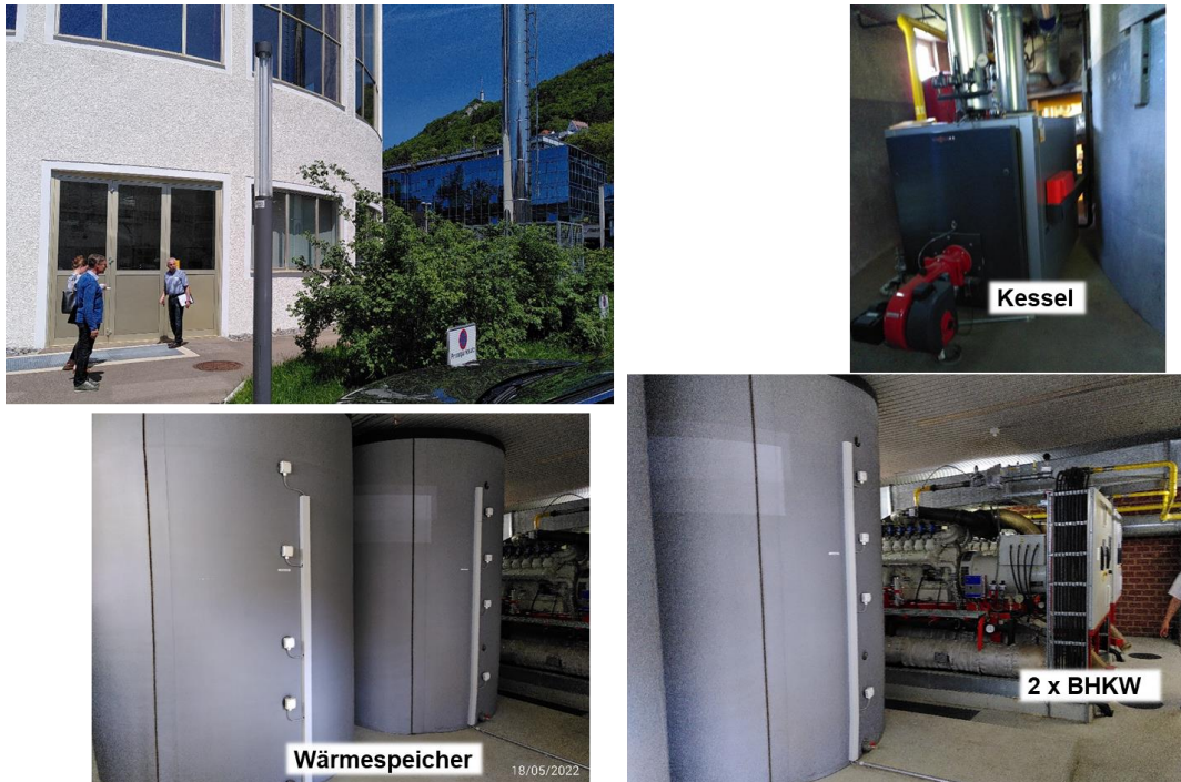
Abb. 10: Heizzentrale Hallenbad Ebingen
